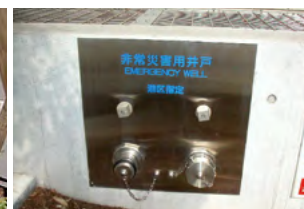
非常災害用井戸の排水口
