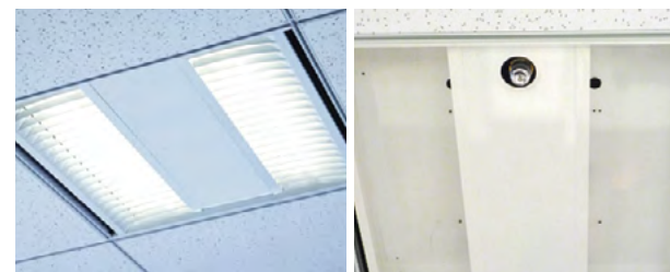
① 既存器具(蛍光灯)
