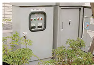
非常災害用井戸の操作盤
