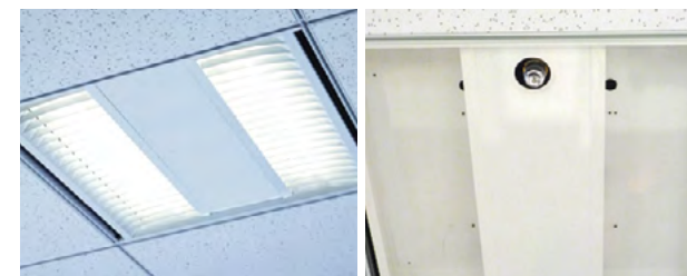
① 既存器具(蛍光灯)
