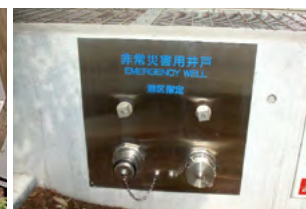
非常災害用井戸の排水口
