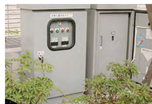
非常災害用井戸の操作盤
