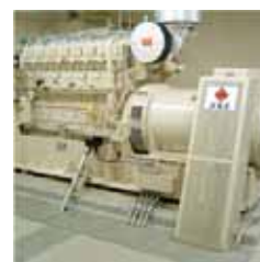
非常用発電システム
