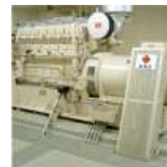
非常用発電システム
