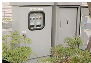
非常災害用井戸の操作盤
