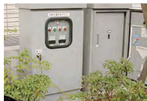
非常災害用井戸の操作盤
