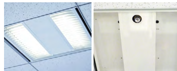
① 既存器具(蛍光灯)
