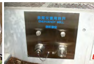
非常災害用井戸の排水口
