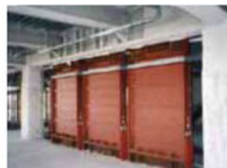
粘性体制振壁
