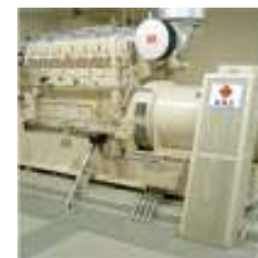
非常用発電システム
