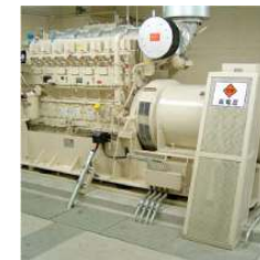
非常用発電システム
