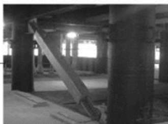
鋼材系ダンパー 「アンボンドブレース」 (192基設置)
