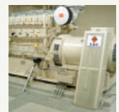
非常用発電システム
